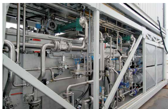
Komplexe Rohrleitungsführung und integrierter Wärmetauscher
